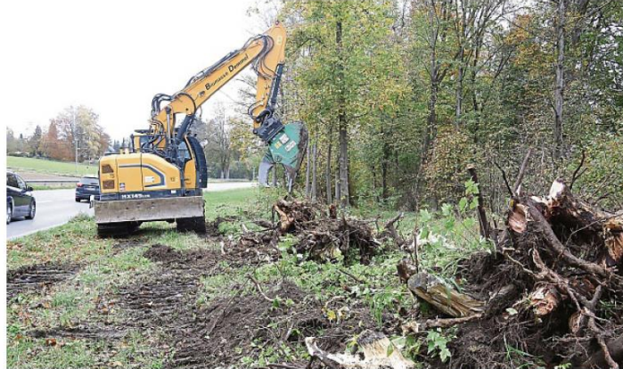
Radweg in Arbeit: Der erste Bauabschnitt zwischen Ebenhausen und der Zufahrt nach Gut Holzen läuft seit Dienstag.
