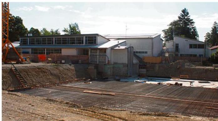
Stockende Bauarbeiten: Die neue Turnhalle an der Grundschule wird voraussichtlich erst im Juli 2027 eröffnet.
