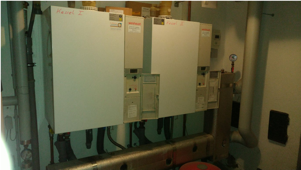
Abbildung 9-4: Brennwert-Kaskadenanlage FFW Icking.
